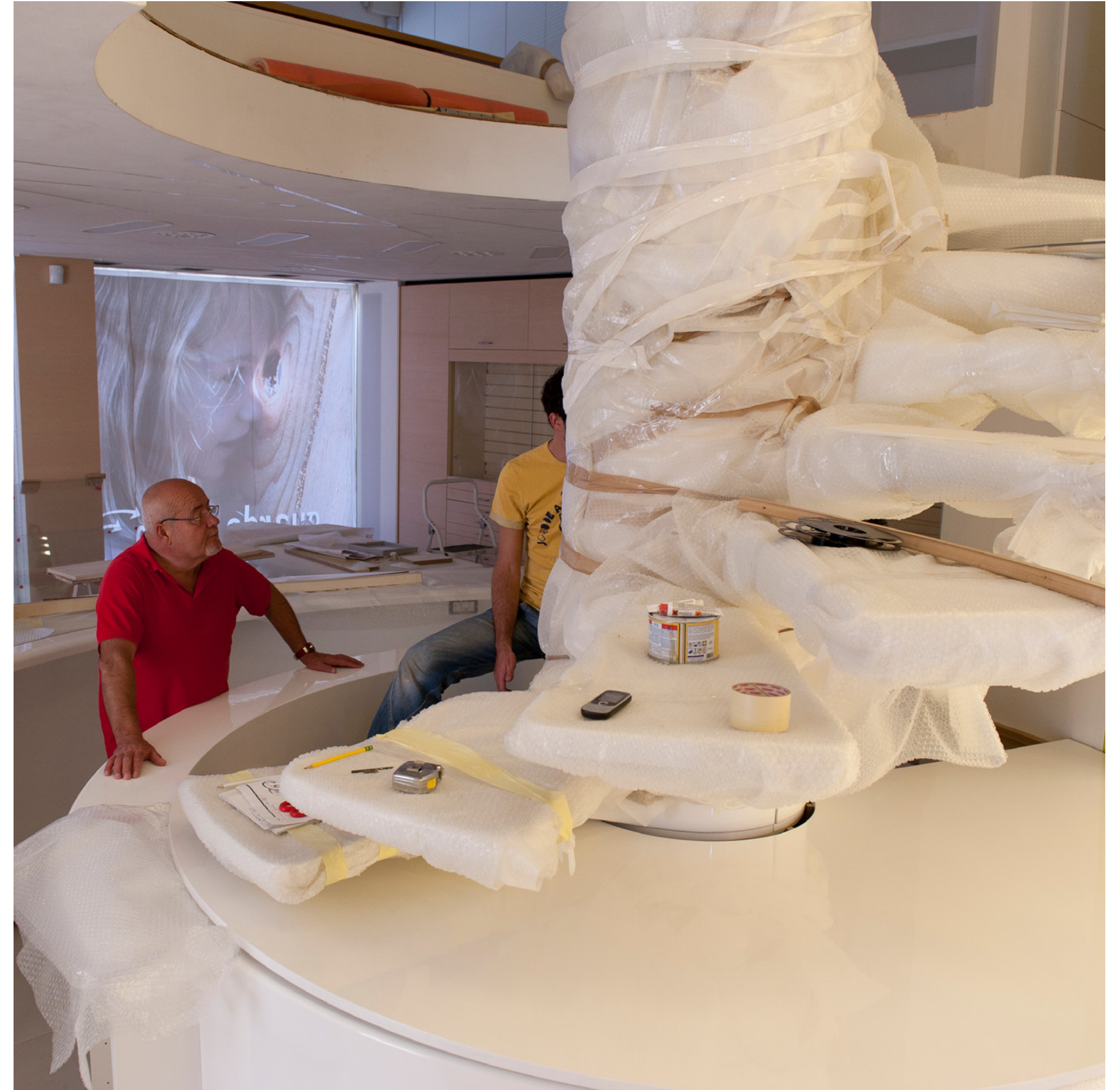
Eugenio Menichini, titolare del centro ottico, segue una delle fasi di montaggio della copertura della scala.
